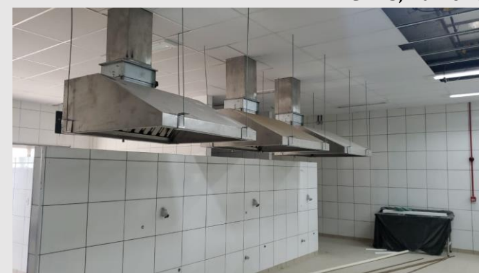
Sistema de Exaustão do Restaurante universitário, CRES, Barreiras
